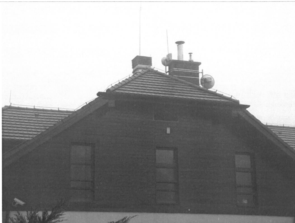
Fot. 1. OM Kobiór / ul Katowicka 141 – widok anteny Emitel na dachu budynku
